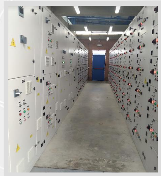
Diseño, Instalación y Puesta en servicio Centro de Control de Motores CCM 460 VAC PTAP La Esmeralda - EAAV
