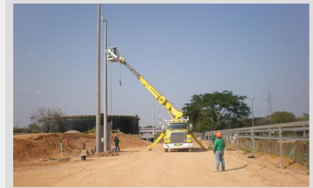
Alumbrado Vías acceso Estación Vasconia III - Ecopetrol -Pto Boyacá
